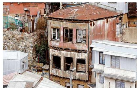
OTRA PROPIEDAD SERIAMENTE DETERIORADA EN LA CALLE CAJILLA.
