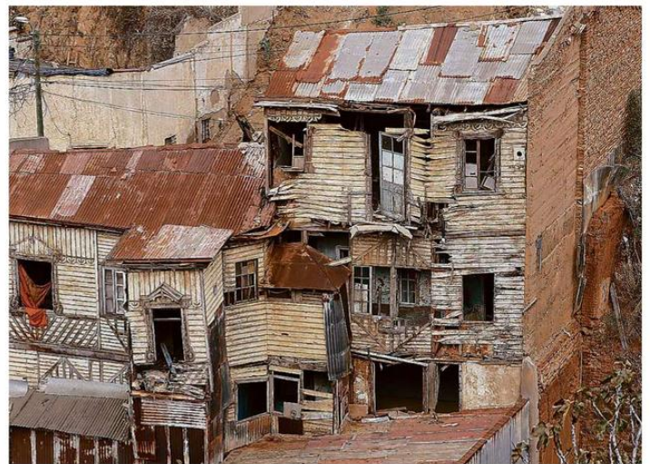
EN LA CALLE CAJILLA DEL BARRIO PUERTO ESTÁ ESTA PROPIEDAD A PUNTO DE DERRUMBARSE.
