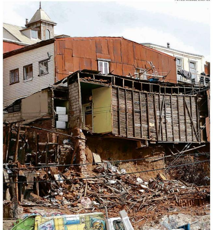
EN LA CALLE BAQUEDANO, EN EL CERRO MONJAS, HAY PROPIEDADES EN ESTADO CALAMITOSO.
